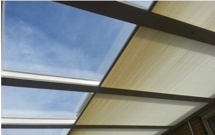
Geplisseerde onderzonwering tussen de liggers
