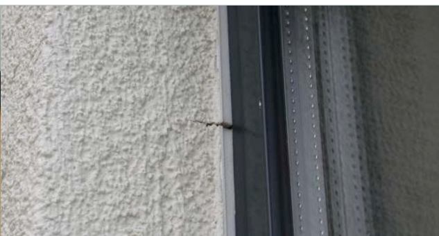
Fissuration de l'enduit à la jonction entre des profilés (l'évolution dépend des caractéristiques de l'enduit et de l'isolant).
