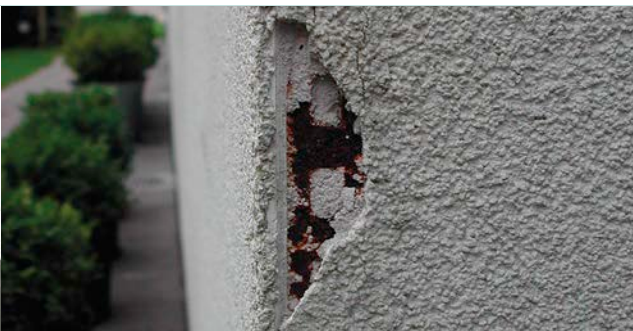
Corrosion d'un profilé d'angle en acier galvanisé.
