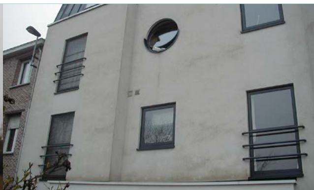
Vieillessement de l'enduit en zone urbaine.
