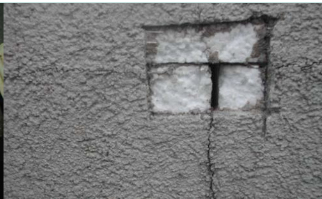
Panneaux d'isolation non jointifs donnant lieu à une fissuration de l'enduit.
