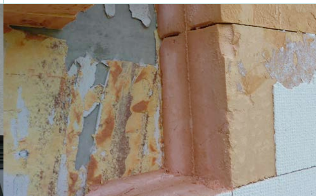
Apparition de la trame des joints entre panneaux d'isolation en surface de l'ETICS révélant l'instabilité dimensionnelle de l'isolant.
