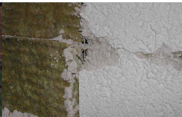
Désaffleurement entre panneaux d'isolation et résistance limitée de l'enduit provoquant la fissuration de ce dernier au droit des jonctions entre panneaux.
