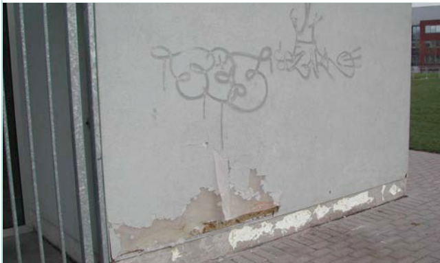
Choix inadapté d'un ETICS dans une zone publique soumise au vandalisme.
