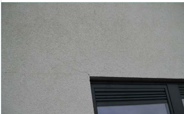
Fissuration de l'enduit aux angles de baie due à l'assemblage de plusieurs morceaux d'isolant et/ou à l'absence de renfort.
