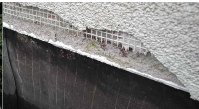
Fissuration et décollement dus à l'armature trop courte qui n'est pas solidarisée au profilé de départ.
