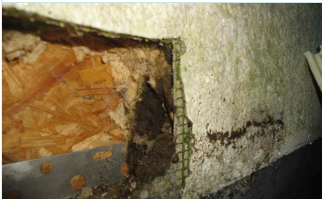
Pourrissement de l'isolant en fibre de bois observé lors du sondage au droit d'une fissure.
