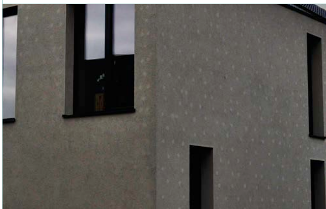
Apparition de la trame des fixations à la surface de l'enduit liée à un pont thermique et aux caractéristiques hydriques de l'enduit.
