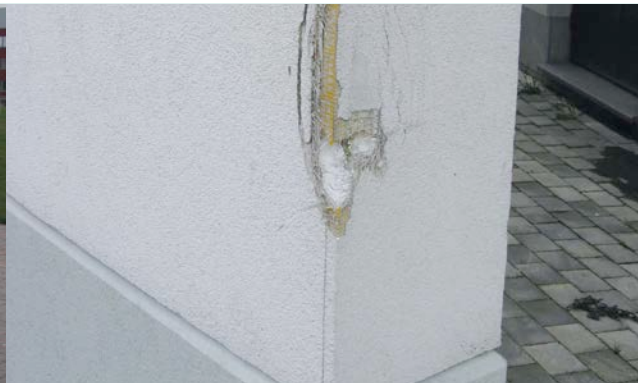
Dégradation mécanique d'un ETICS dans une zone d'accès destinée aux camions.
