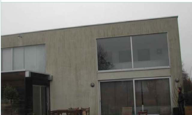
Vieillessement prématuré de l'enduit.
