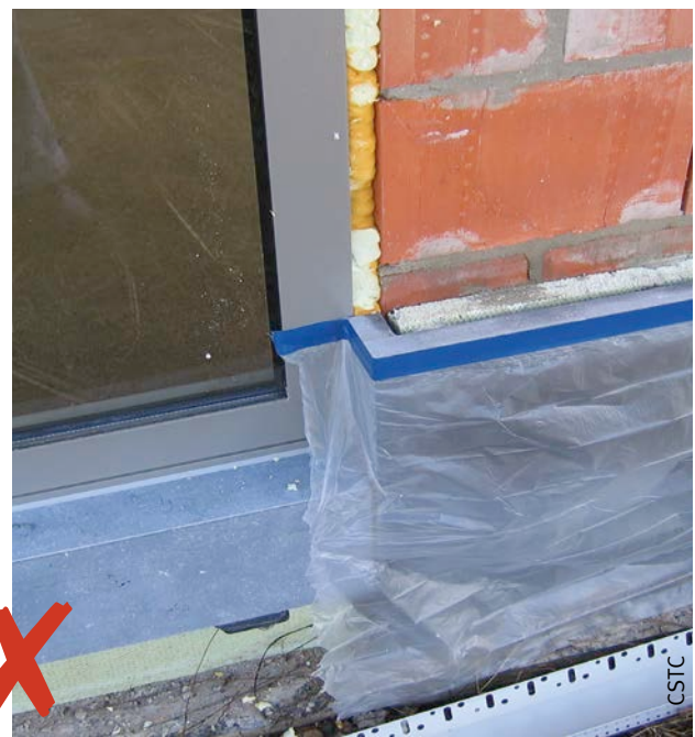
B. Non conforme à la PEB
