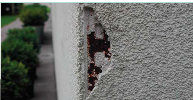
Corrosie van een hoekprofiel in gegalvaniseerd staal.
